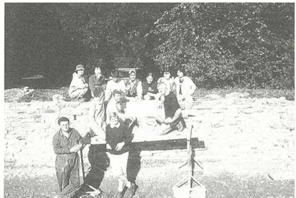
写真8 10日間の作業終了の記念撮影 修復作業は、傷んでいるところを崩し、使える石を再利用して積み直した。足りない分は補充。積み方は個人の裁量にまかされるが、天端石だけは専門家が積む。
