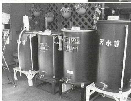
雨水リサイクル研究所横 に設けられた雨水タンク 展示場
