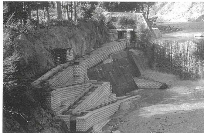
岐阜県坂内川にある堰堤と階段式の部分魚道。上流の集落から濁水が大量に流れているのが見える。
