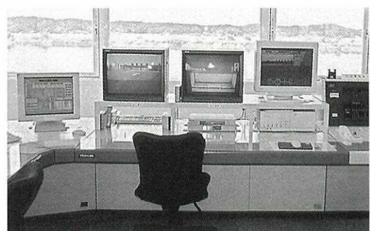
新洗堰の操作室 ガラス張りになっていて、操作の様子を見学することができる
