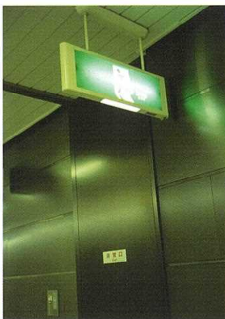
写真5. 非常口のピクトグラム ピクトグラムの右手に非常口があるが、左向きの人物が描かれている。設置の向きにも注意する。
