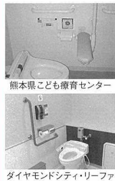
写真6. 多目的トイレ 便器まわりの装置
