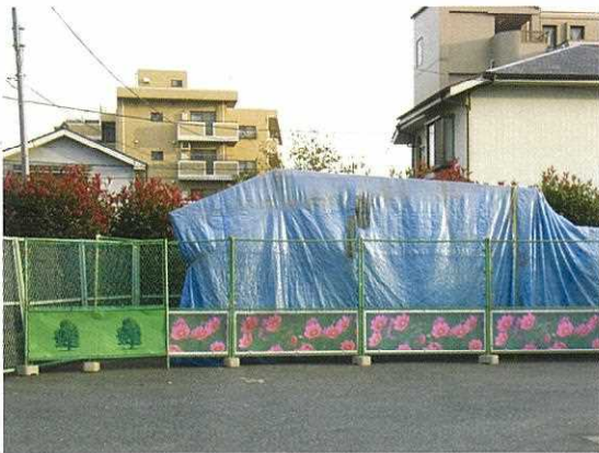
防護柵の絵 工事現場には、花や緑の絵や写真が貼られていることもあるが、景観に調和するだろうか？
