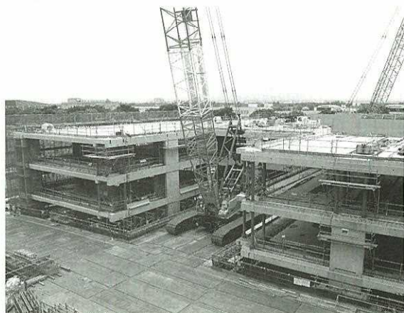
立川市新庁舎の建設現場 低層（地上3階・地下1階）、大平面、吹き抜けと中庭の配置を建物の基本的な考え方として、屋上緑化や太陽光発電の活用など環境面にも配慮されている
