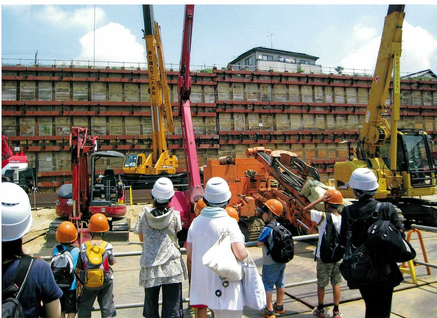
科学技術館サイエンス友の会の子供たちが参加した 東京外かく環状道路工事の現場見学会
