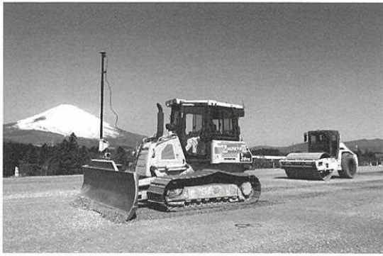
写真3. ICT建設機械施工状況 3次元マシンコントロールブルドーザ& GNSS搭載振動ローラ
