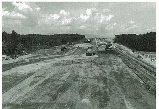
写真2. 新東名高速道路湯船原トンネル工事 神場工区本線盛土場全景
