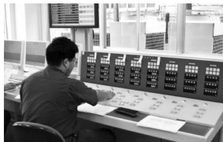
写真6 操作係のゲート操作状況(利水ダム・第一類ダムの5門のクレストゲート)。その他4カ所の警報所のサイレン吹鳴を実施
