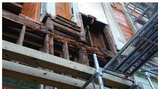
腐朽状況（北側外壁の一部）
