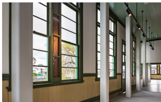
耐震補強柱（一階東側回廊）
