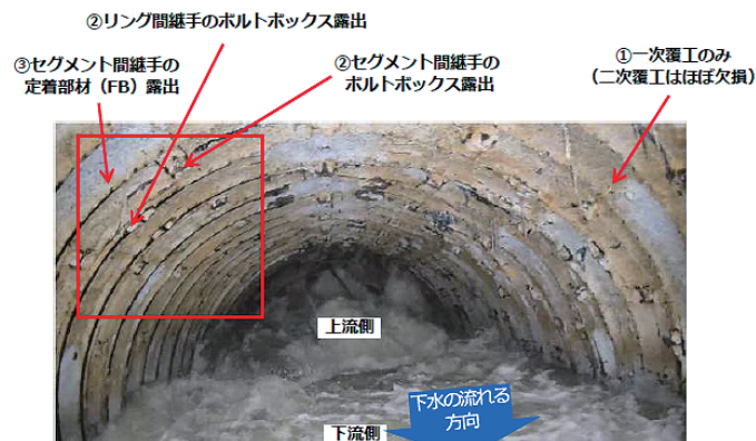
チュウ4MHから下流20～50m付近の状況 (事故後に撮影・撮影日 2025/2/5)
