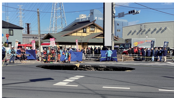
2025年1月28日(火) 現場状況 (埼玉県)復旧工法検討委員会資料より
