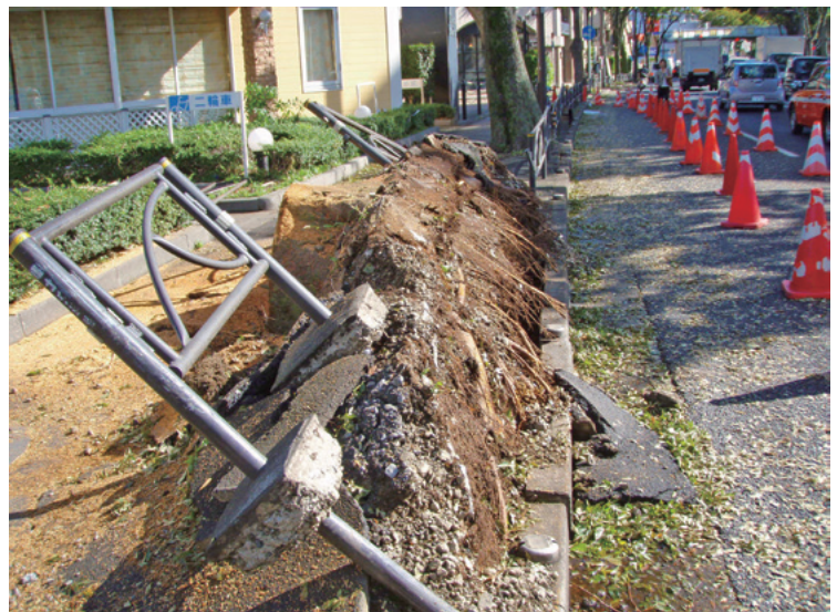
狭小植樹により倒伏したケヤキの根系
