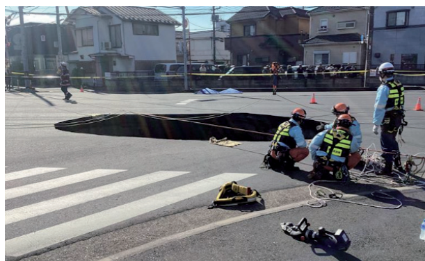
2025年1月28日(火) 現場状況 (埼玉県)復旧工法検討委員会資料より
