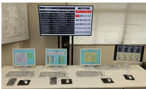
ダムシミュレータ装置
