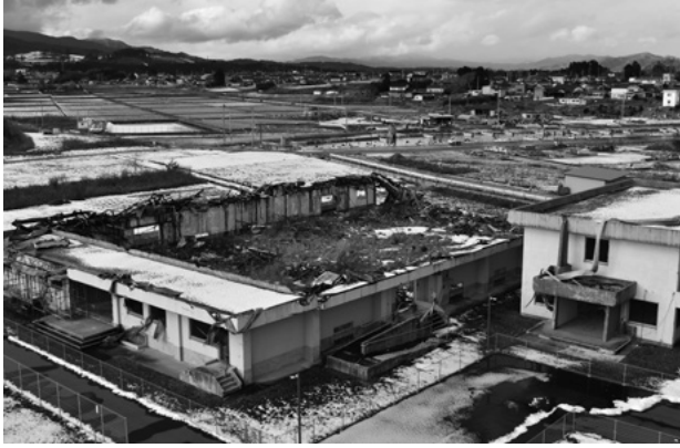
屋根や床板が流され無残な姿の屋内運動場
